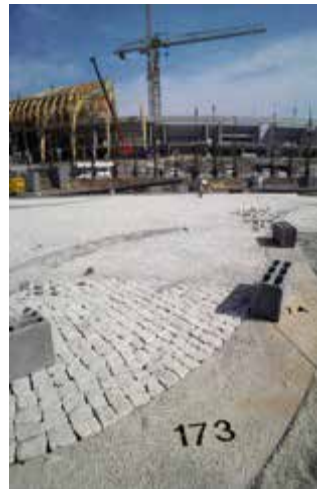
Fig. 23 - Calçada portuguesa na Expo'98, projeto de Fernando Conduto, em fase de construção, 1997. (Fotos: EM)
