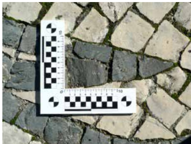
Fig. 29 - Medição de calçada na Expo'98, no desenho de Rigo. Pedras de tamanho médio de 7X8cm. (Foto: EM)
